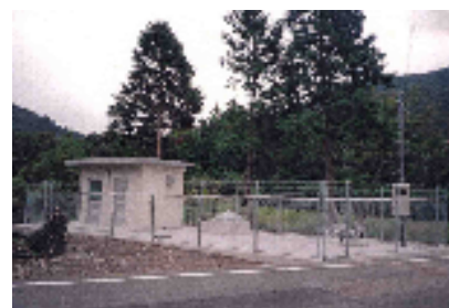
【写真：名留川取水ポンプ】
